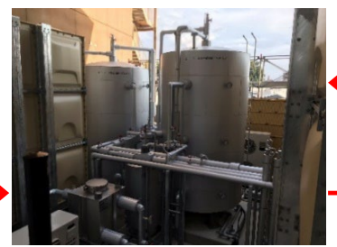
貯湯・蓄熱タンク (お湯をためる)
