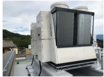
空冷ヒートポンプチラー (電力で風呂をわかす)
