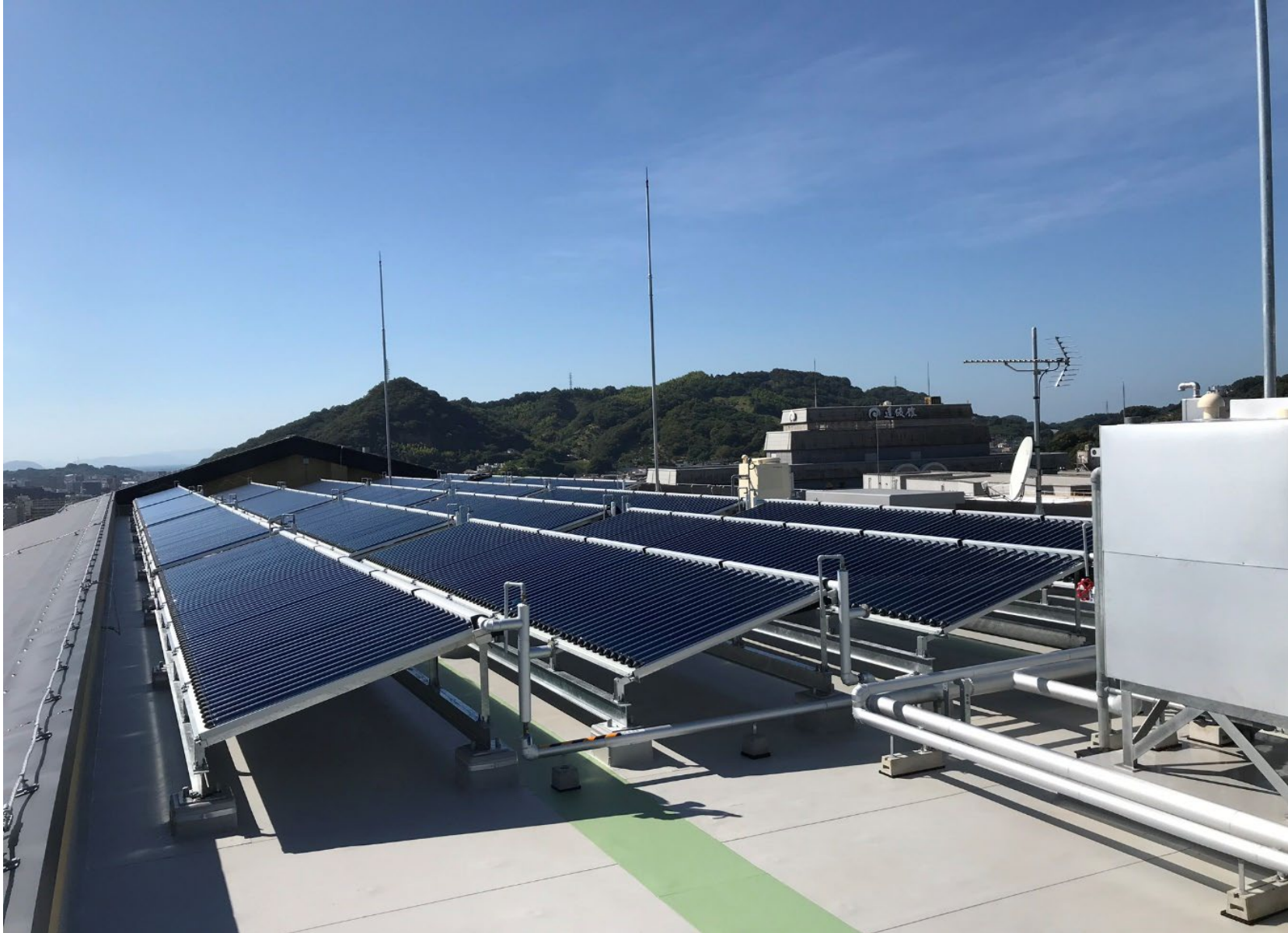
真空2重ガラス管式太陽熱集熱器（集光ミラー形）：2.28㎡×108台
